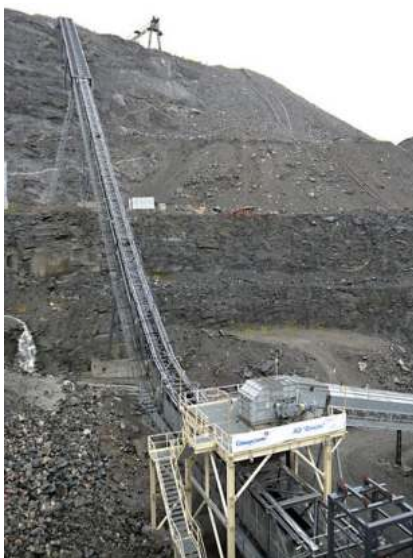
Рисунок 1.8 – Крутонаклонный конвейер в Оленегорском карьере Достоинствами конвейерного транспорта являются:
