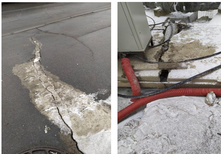
Рисунок 2.3 – Трещина, образованная в период активной стадии заморозки станции метро «КазакOVская»
