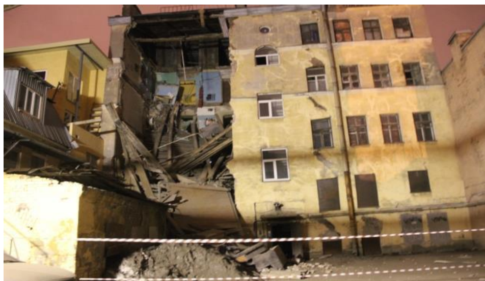
Рисунок 1.1 – Фото аварийного дома (Санкт-Петербург)
