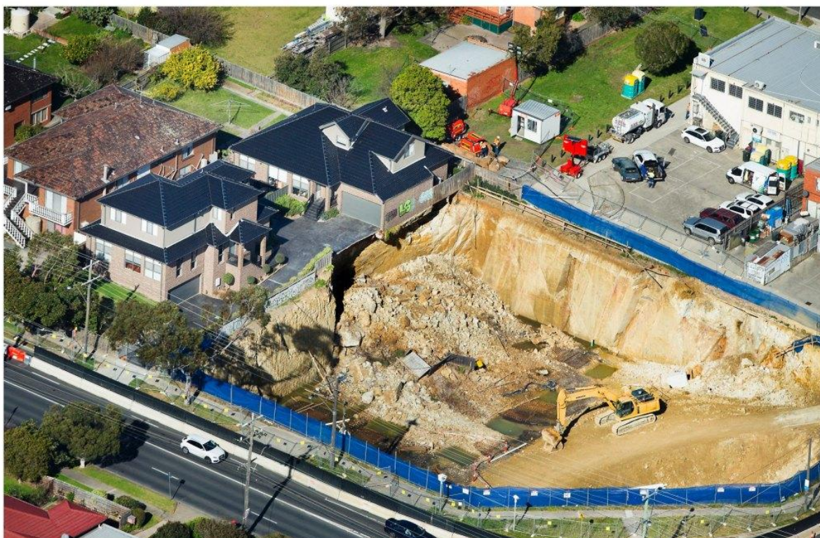
Рисунок 1.4 – Вид обрушения грунта на строительной площадке Маунт-Уэверли
