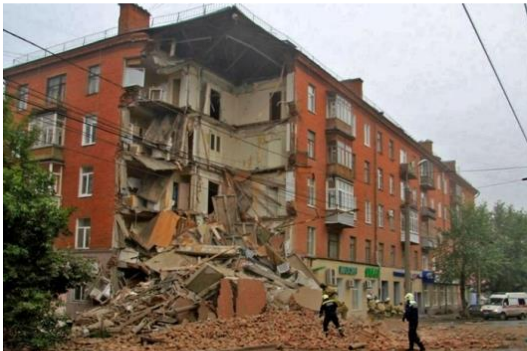
Рисунок 1.2 – Вид жилого дома в Перми после аварии
