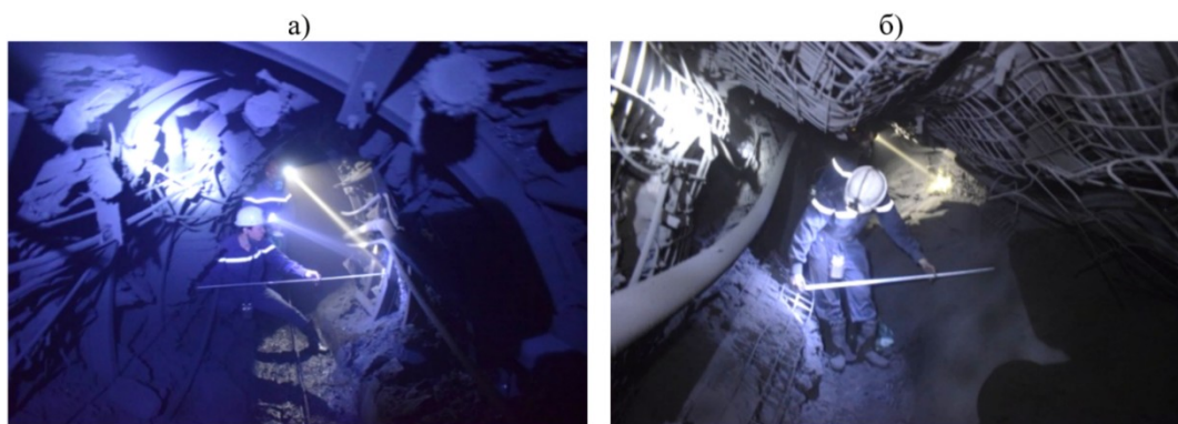
Рисунок 1.17 – Состояние подготовительных выработок, закрепленных арочной (а) и анкерной (б) крепью, при отработке пласта 11 (шахта «Хечам») с труднообрушающимися породами кровли.
