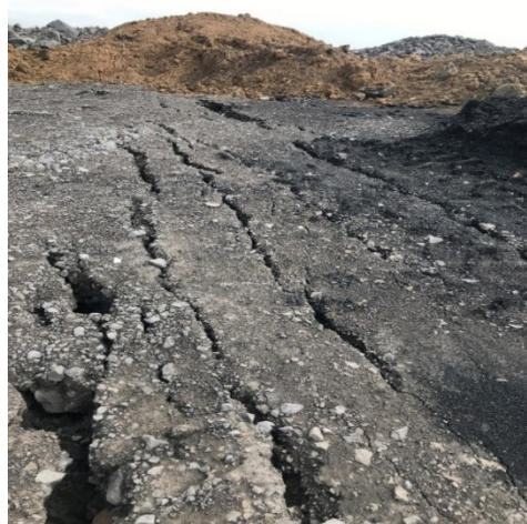
Рисунок 4.10 – Трещина отрыва на поверхности дамбы бывшего гидроотвала
