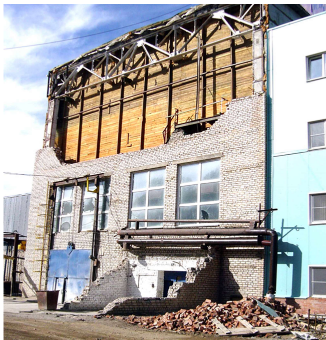
Рисунок 2.14 – Частичное обрушение каменной кладки здания административно-бытового комплекса [14]
