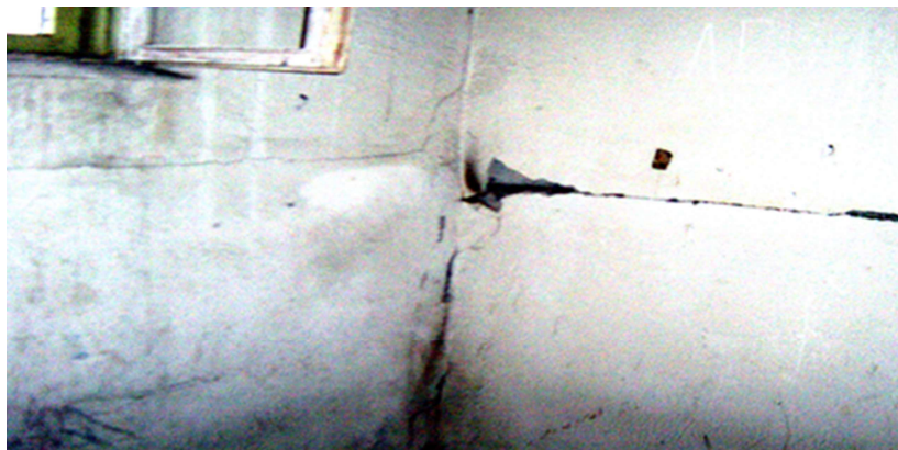
Рисунок 5.11 – Характерные дефекты несущих элементов строительной конструкции девятиэтажного жилого дома, расположенного по адресу: Ленинградская обл., г. Каменногорск, Ленинградское шоссе, 92 [101]
