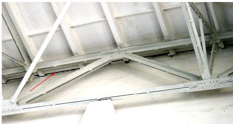
Рисунок 2.15 – Щель (показана стрелкой) между стеной и крышей в здании подъемных машин
