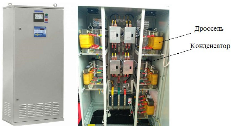
Рисунок 3.4 - Общий вид конденсаторной установки с антирезонансными дросселями
