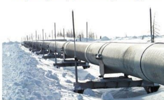
Нефтепровод «Ванкор – Пурпе»
