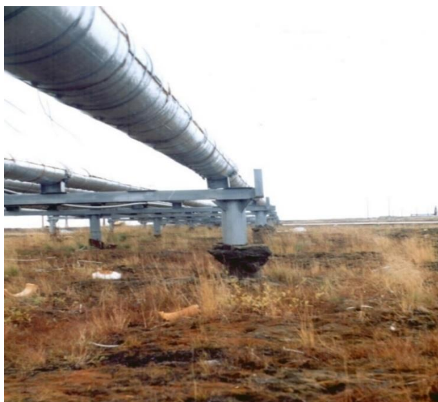
Рисунок 2.5 – морозное выпучивание опор надземного трубопровода [105]
