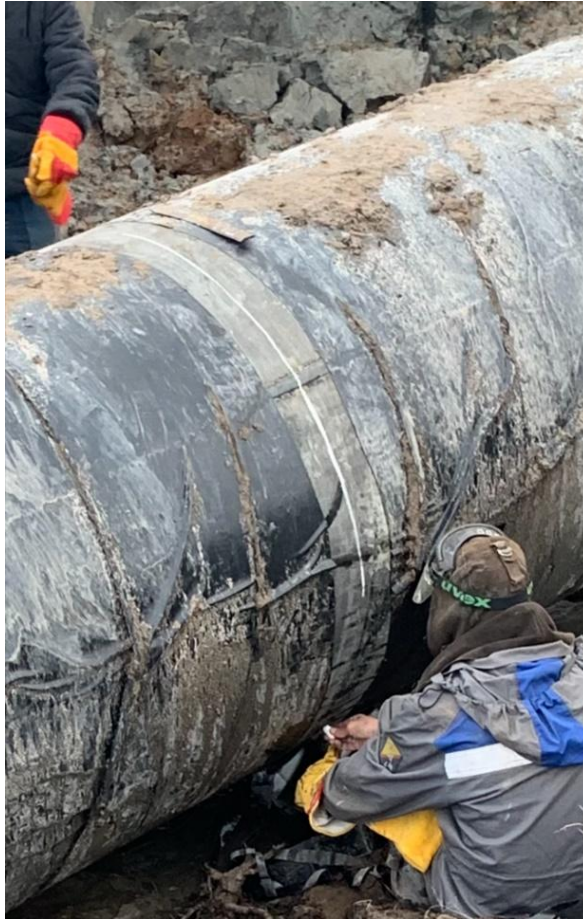
Рисунок 4.11 – Неровности изоляционного покрытия, характерные для эксплуатируемого магистрального трубопровода
