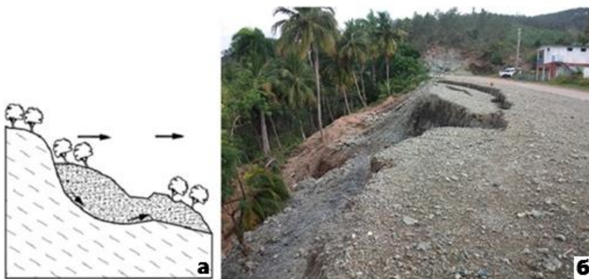
Рисунок 2.12 - Вращающийся оползень на дороге Маиси-Баракоа: а) схема оползня [146]; б) фотография оползня (фото автора)
