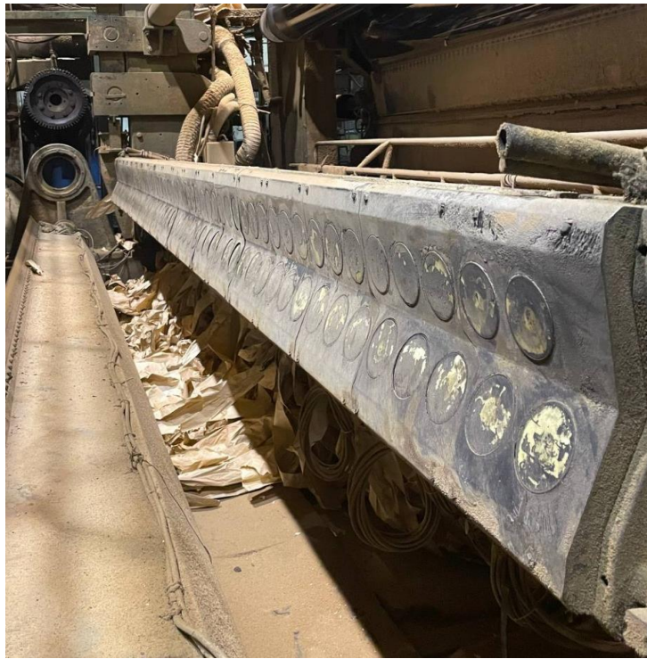
Рисунок 4.13 – Катушки на индукционной балке на БДМ № 7 (фото автора)
