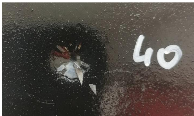
Рисунок 4.8 – Вскрытие отслоившегося покрытия П/Э [фото автора]
