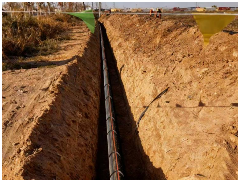
Рисунок 3.12 – Вид газопровода с волоконным кабелем на экспериментальном участке (фото автора)
