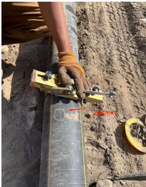
Рисунок 3.3 – Искусственно сформированное отверстие для имитации утечки газа из газопровода (фото автора)
