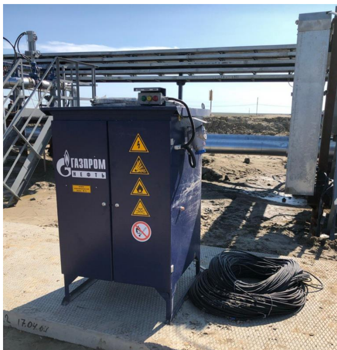
Рисунок 4.3 – Устройство дозирования химических реагентов на рассматриваемом месторождении (фото автора)
