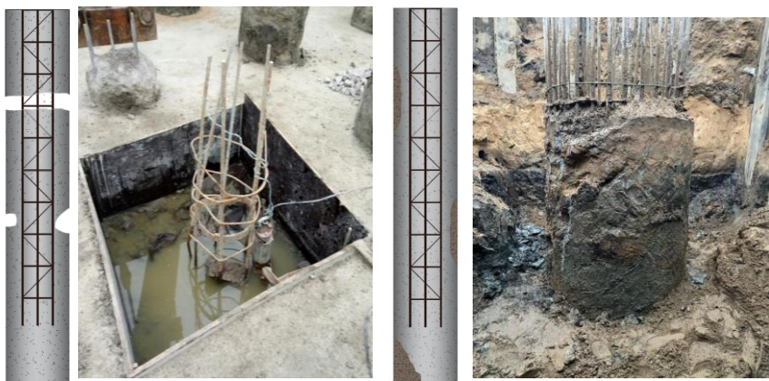
Рисунок 2 – Дефекты в сваях «размытие бетонной смеси» и «вывалы грунта»
