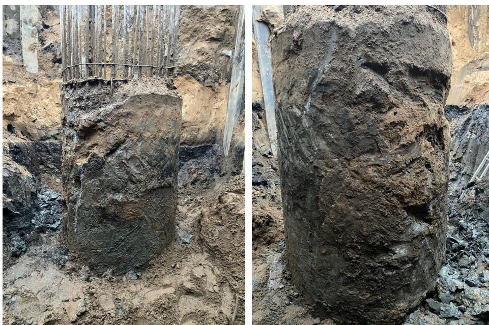
Рисунок 1.8 – Дефект в свае, изготавливаемой в грунте, «вывалы грунта»
