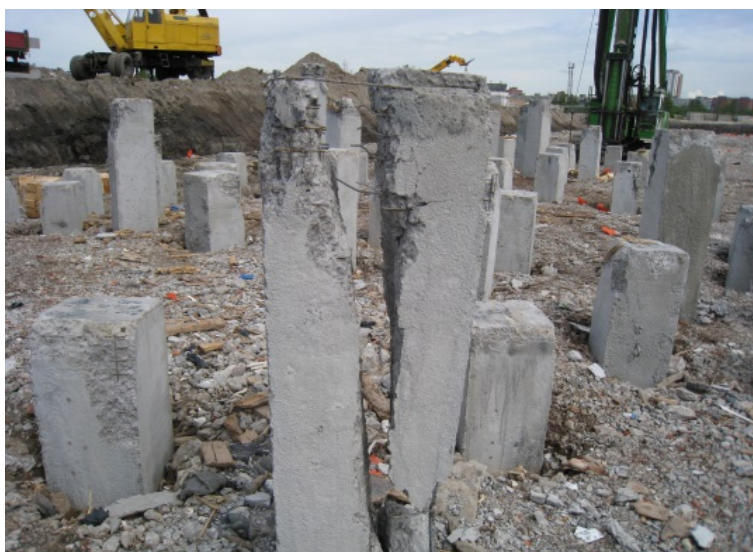
Рисунок 1.5 – Дефекты в сваях заводского изготовления
