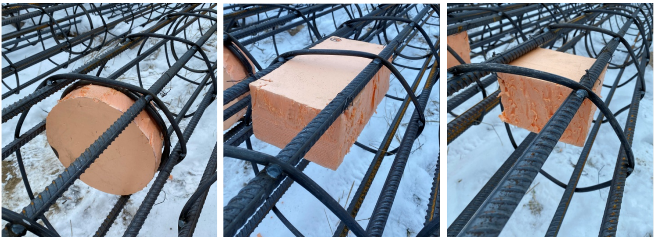
Рисунок 3.5 – Арматурные каркасы с искусственными дефектами
