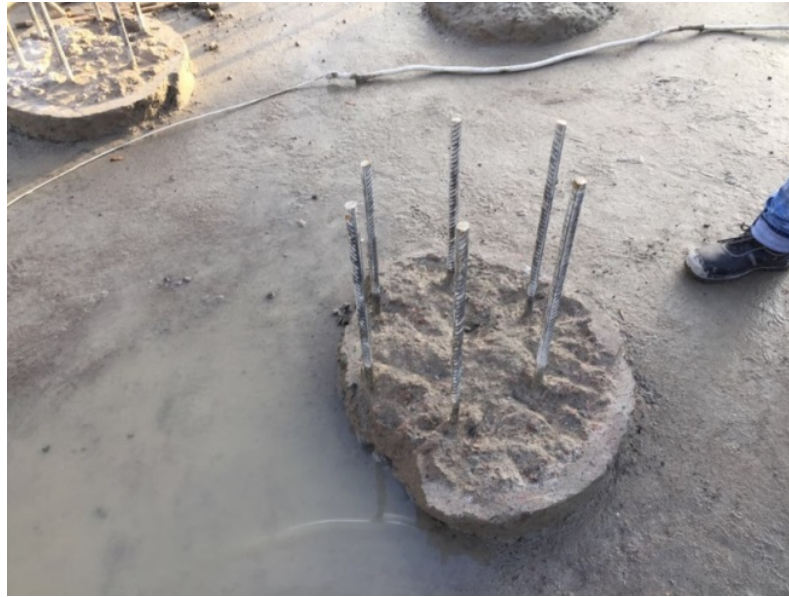
Рисунок 1.10 – Дефект в свае, изготавливаемой в грунте, «выдавливание бетона»
