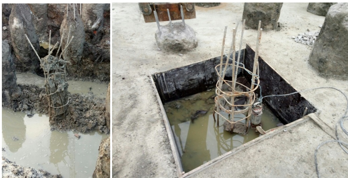
Рисунок 1.7 – Дефект в свае, изготавливаемой в грунте, «размытие»
