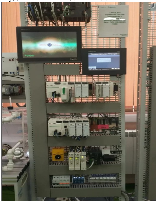
Учебно-тренажерный комплекс – Система управления удаленным вводом/выводом на базе ПЛК Modicon M580/ Modicon M262
