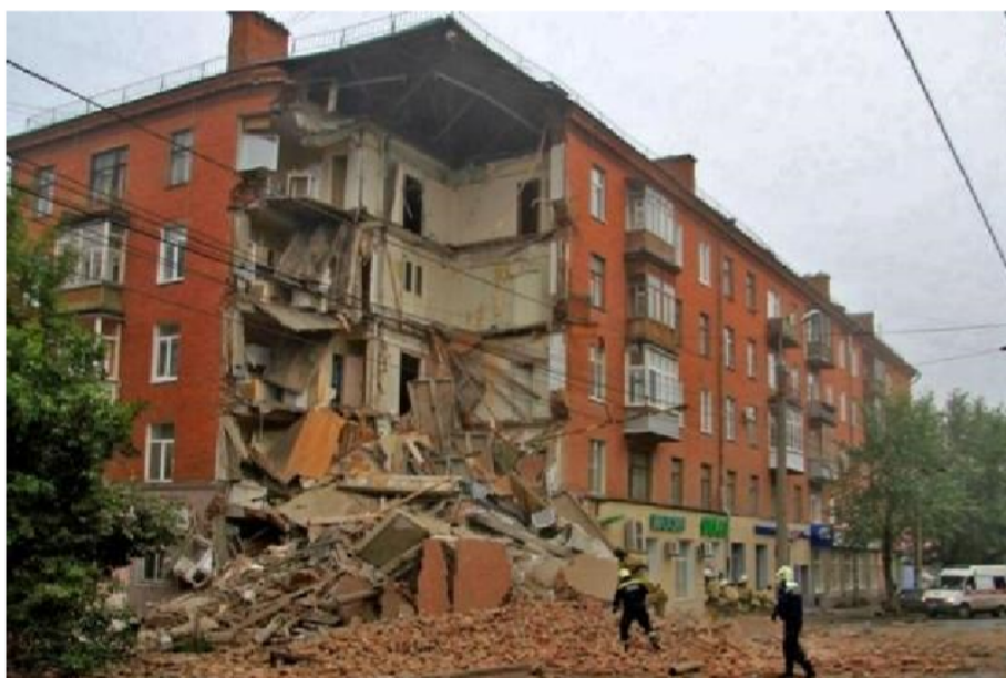
Рисунок 1.2 – Вид жилого дома в Перми после аварии
