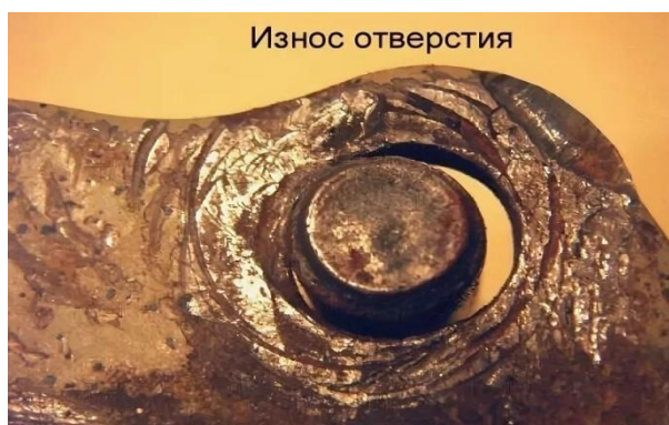
Рис. 11. Фото изношенного отверстия (подшипника)
