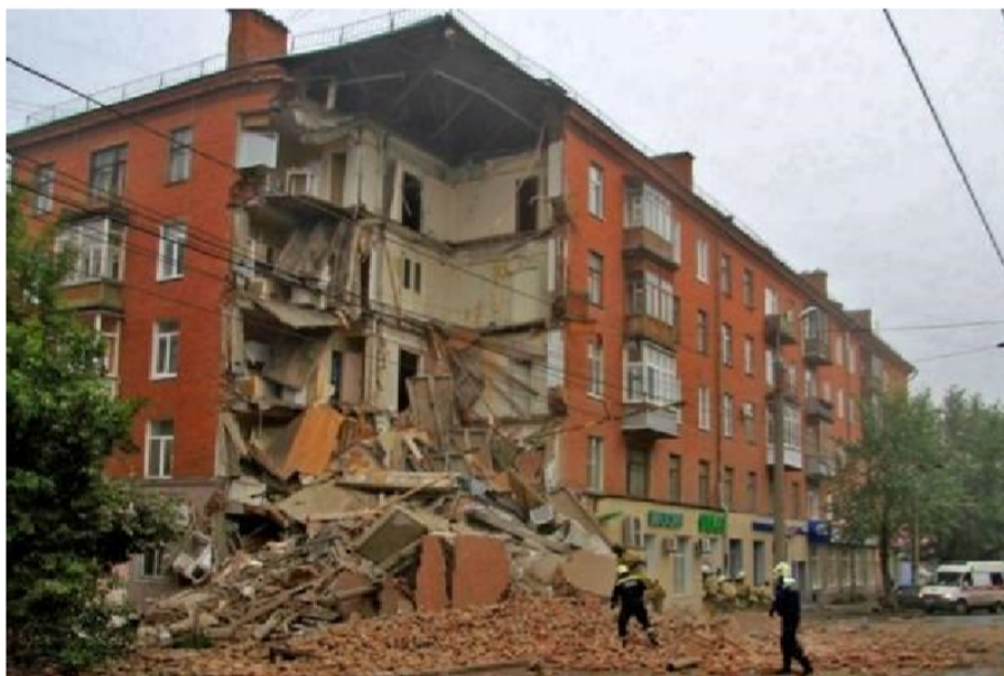
Рисунок 1.2 – Вид жилого дома в Перми после аварии
