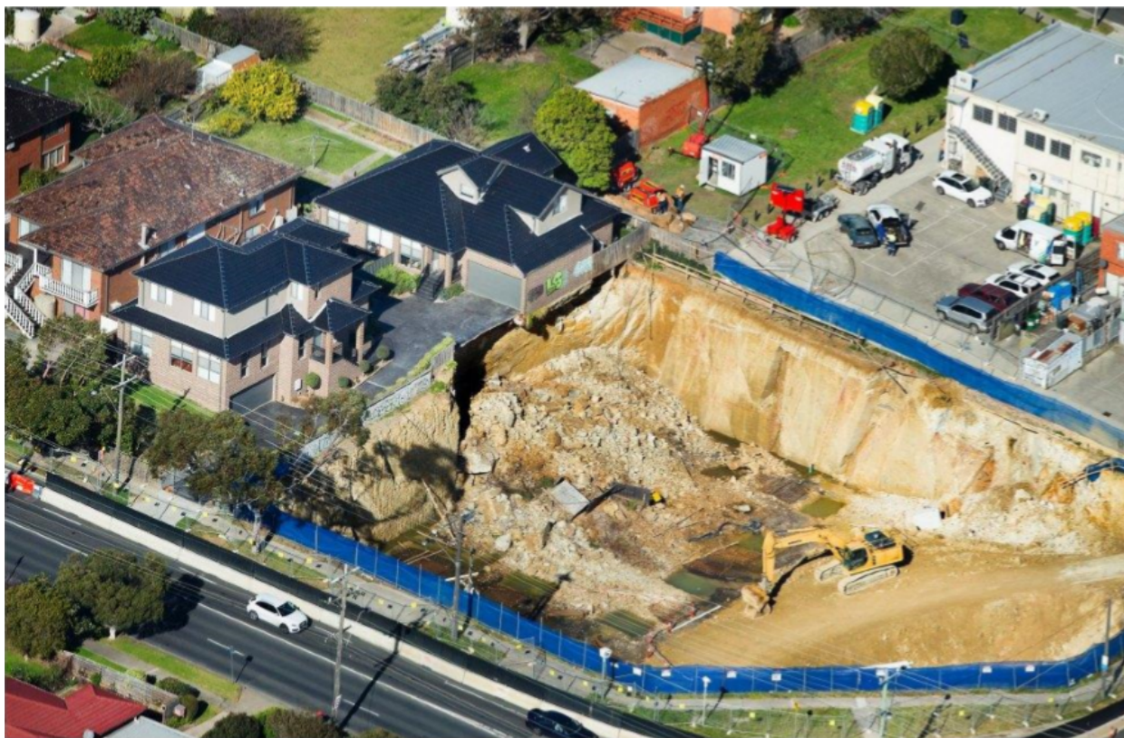
Рисунок 1.4 – Вид обрушения грунта на строительной площадке Маунт-Уэверли
