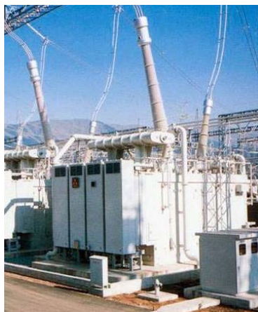
Рис. 6. Промышленный повышающий трансформатор
