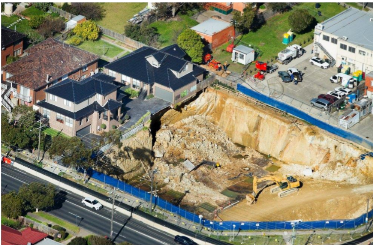
Рисунок 1.4 – Вид обрушения грунта на строительной площадке Маунт-Уэверли
