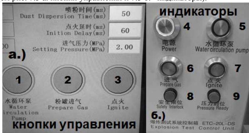
Рис. 7.3. Увеличенные фрагменты панели блока управления взрывной камерой:
