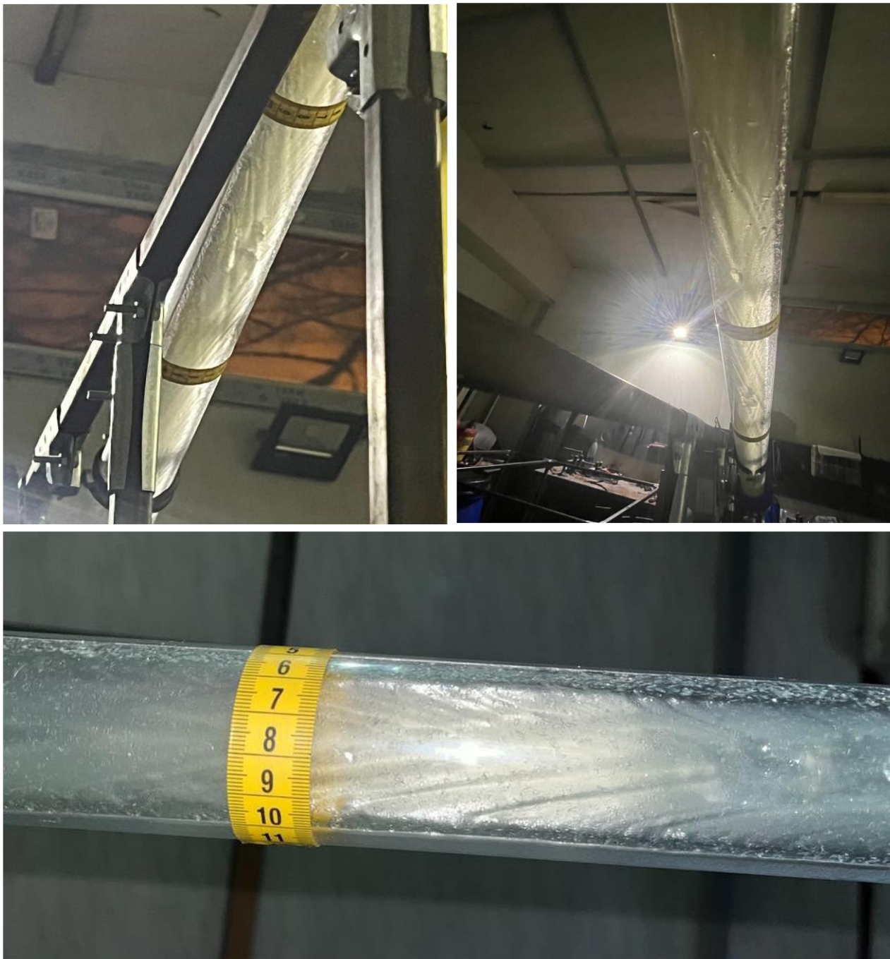
Рисунок 3 – Волны на поверхности перекачиваемого дизельного топлива на самотечном участке трубопровода экспериментального стенда
