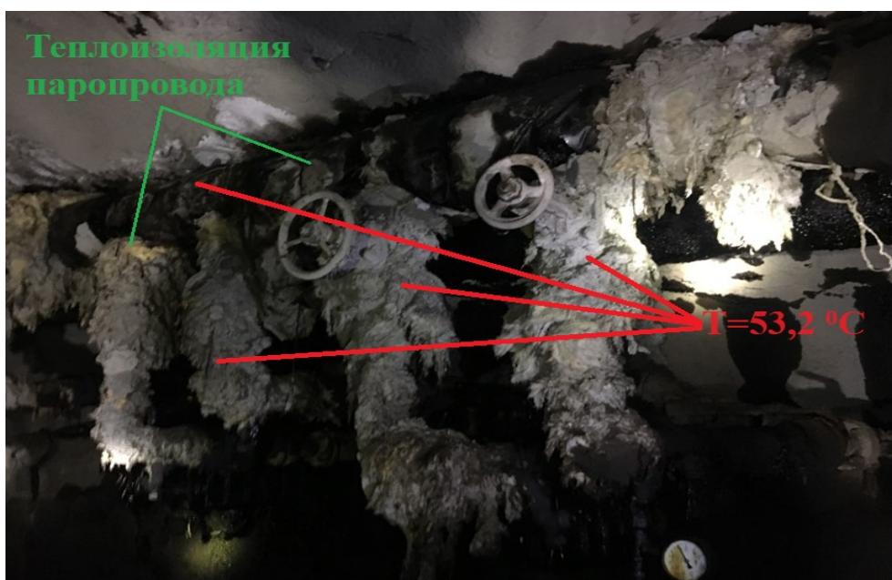
Рисунок 3.11 — Изображение паропроводов, расположенных в буровой галерее
