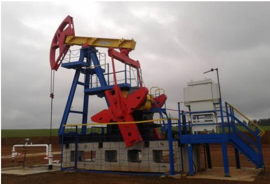
Рисунок 5.2 – Общий вид станка-качалки СКДР-8-3 с вентильным двигателем ВДПМ-СК-22В и станцией управления Danfoss-SALT-ВД
