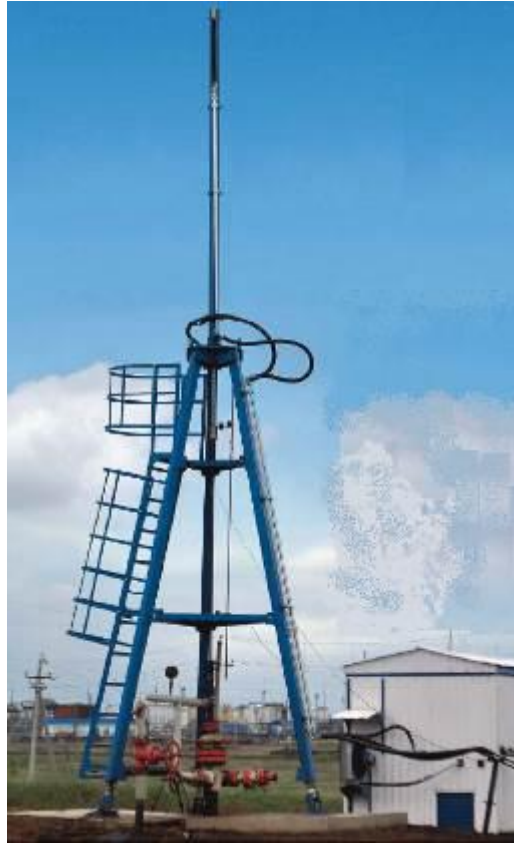
Рисунок 3.12 – Общий вид ЭГП УШСН типа ГПШСН 80-3,5 «Гейзер» на скважине
