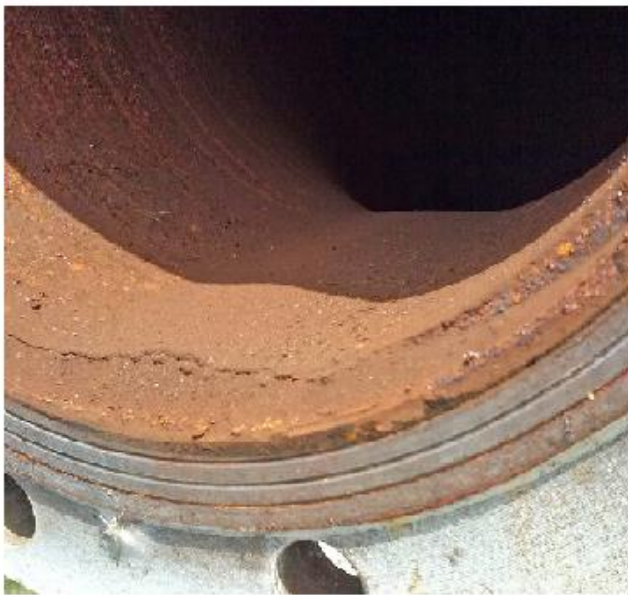
Трубопровод отвода газовой фазы
