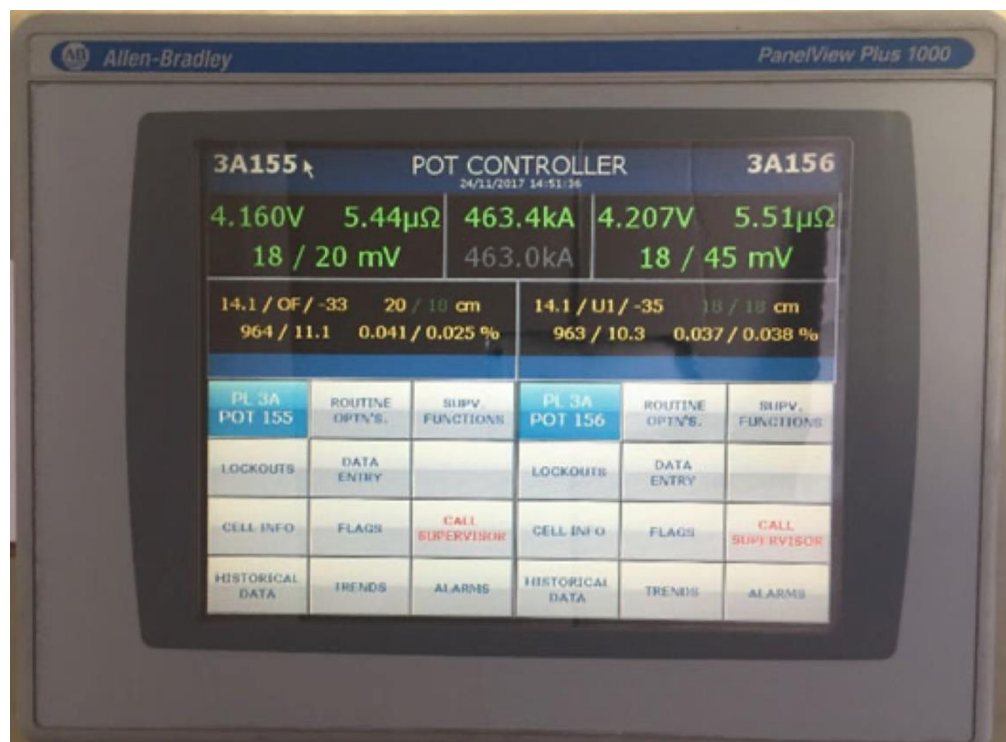
Рисунок 2.5 – НМІ-панель оператора, установленная возле пары электролизеров DX+ компании ЕГА на заводе в Аль-Тавиле. Источник: [105]
