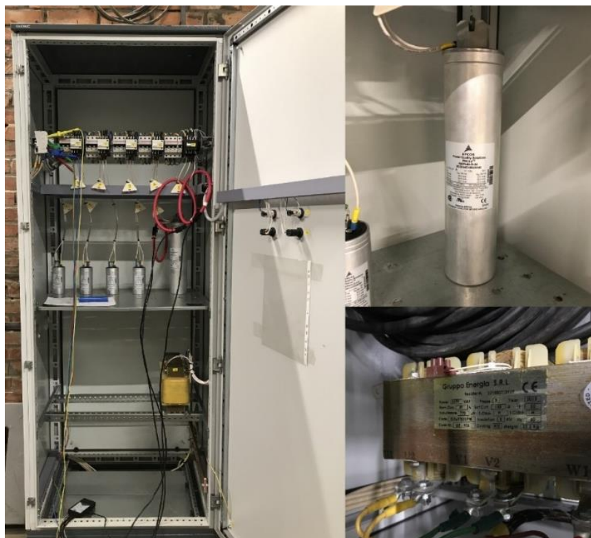
Рисунок 3.26 - Общий вид пассивного фильтра (слева) и конденсатор с реактором укрупненно (справа) (фото автора)
